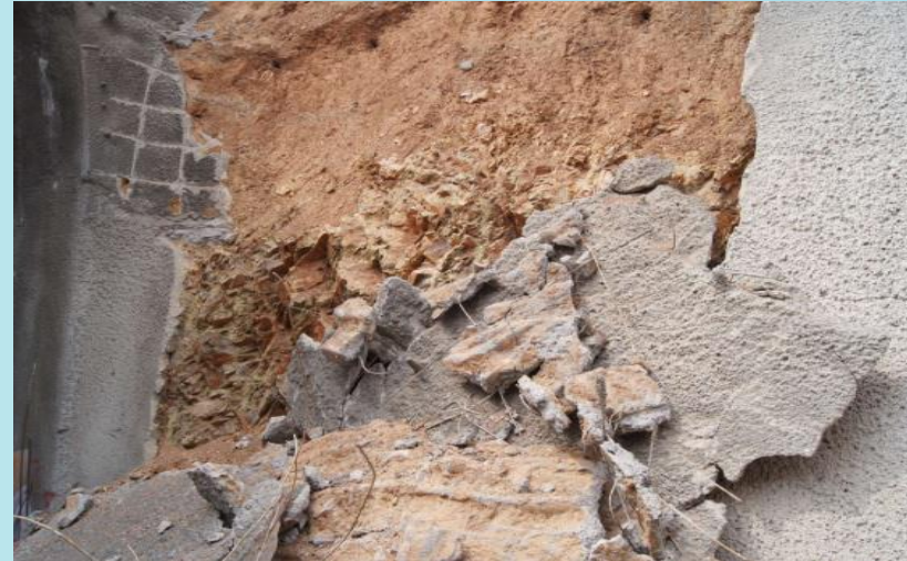
喷射混凝土开裂、剥落、离层
